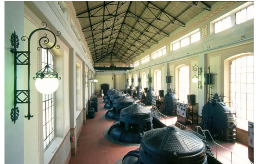
Argenta, Impianto Idrovoro Saiarino
